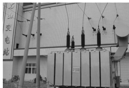
(a) 位于石山变电站的待测变压器
